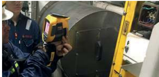
Termografía Eléctrica Bornera
