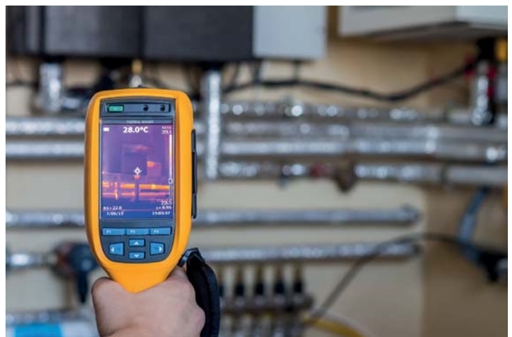
Termografía Eléctrica - Tableros
